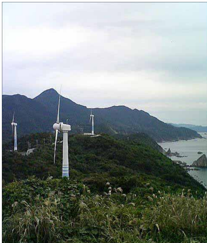
写真 鹿児島県野間岬ウインドパーク発電所（九州電力：300kW/基 10基）
