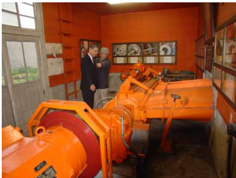
写真 長野県軽井沢町リゾートホテル自家発電用 70kW 小水力発電
