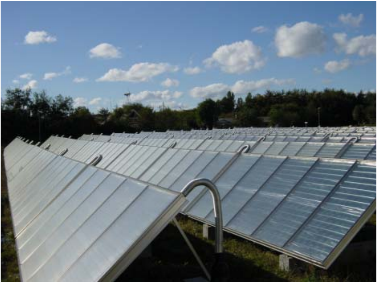
写真 地域暖房に用いられる太陽熱利用の温水供給施設
