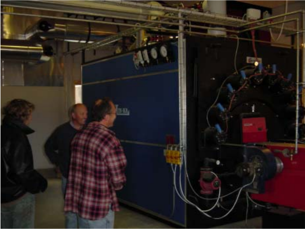
写真 地域暖房の温水供給に用いられるバイオマス燃焼装置
