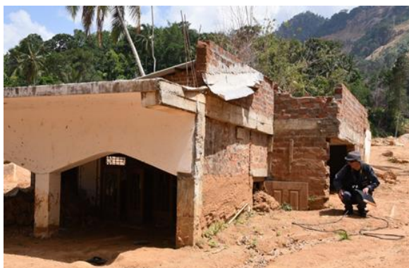
写真5 土砂で埋もれそうな住宅
